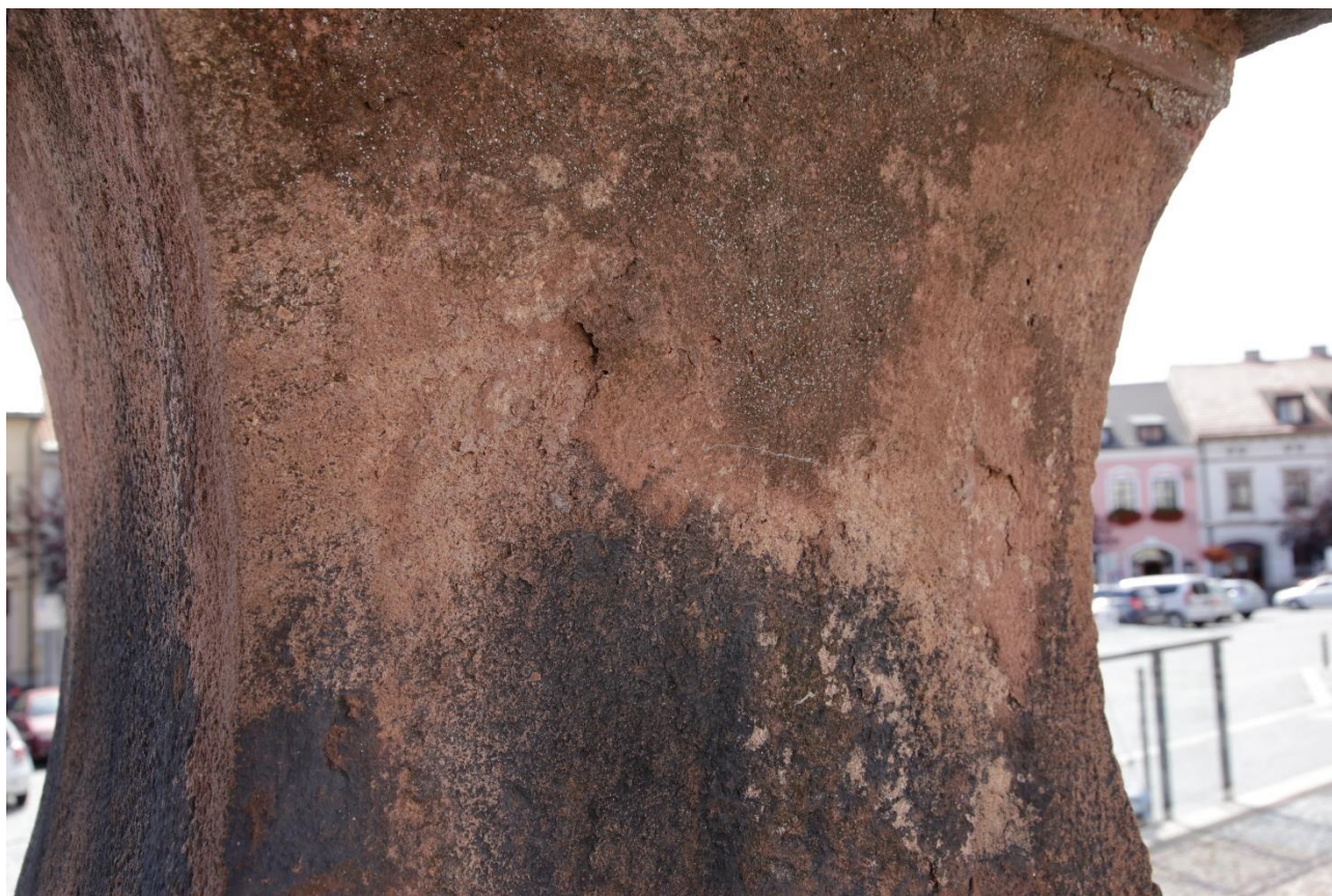
Obrázek 30 pískovcový sokl, detail stavu povrchu
