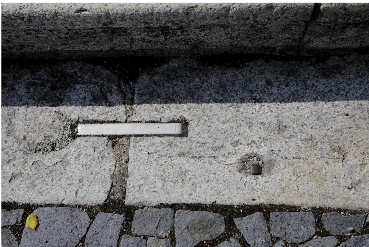
Obrázek 35 poškození žulových schodů kovovými prvky
