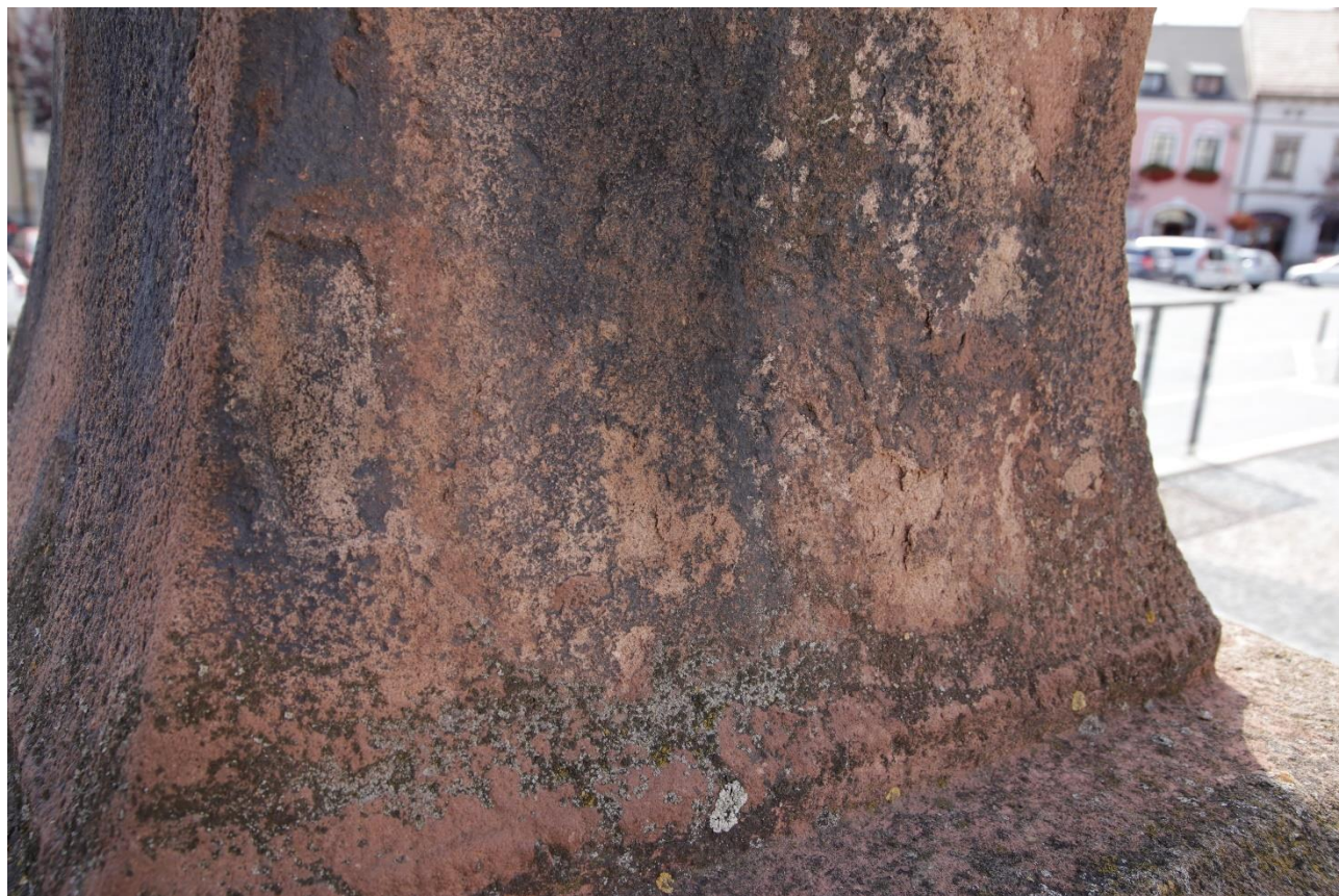
Obrázek 29 pískovcový sokl, detail stavu povrchu
