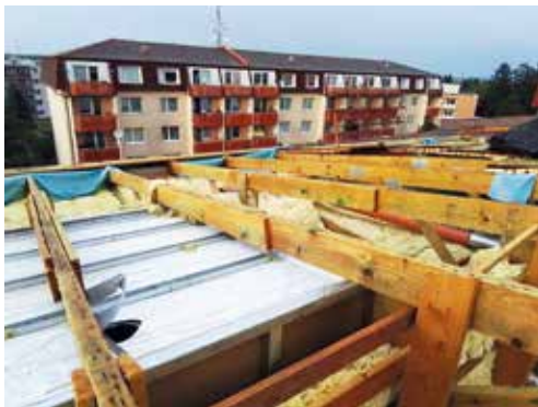
Poníčená střecha bytového domu. | Foto: Archiv SDH
