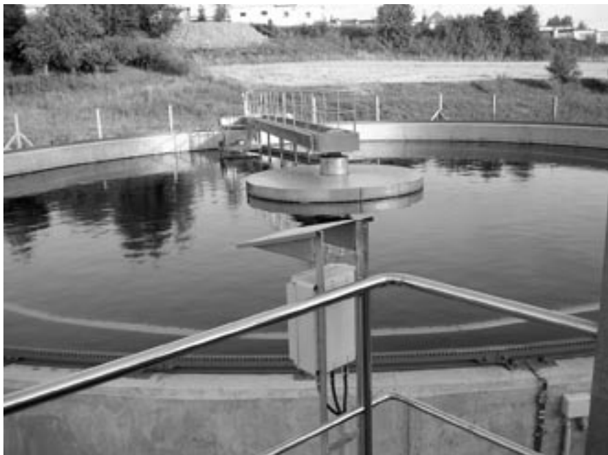
Pohled na novou dosazovací nádrž
